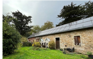
Toiture photovoltaïque, Douarnenez. © Fabien Sénéchal (ANABF)
